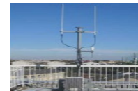
通信施設の整備
